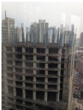
マニラのビジネス街 マカティにある廃墟ビル 97年アジア通貨危機の時に工事がストップし、そのまま今に至っているらしい。2013年5月筆者撮影
